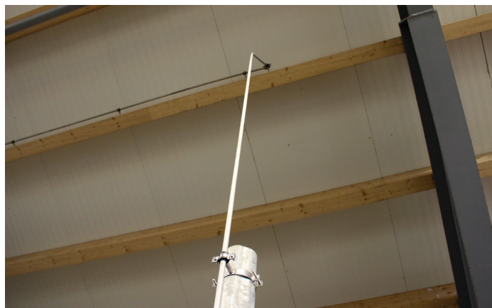
Røranlegget i taket.
